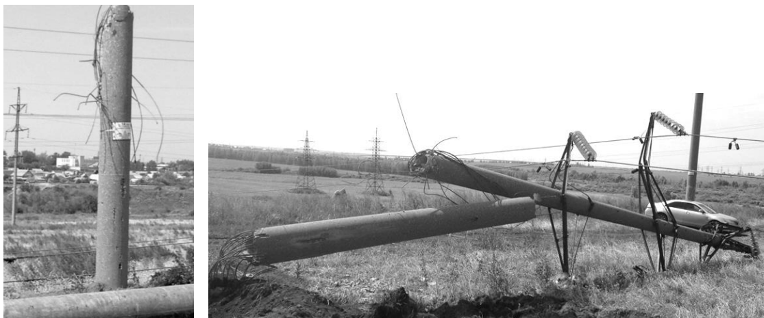
Рис. 2. Разрушение железобетонных опор ВЛ 110 кВ
